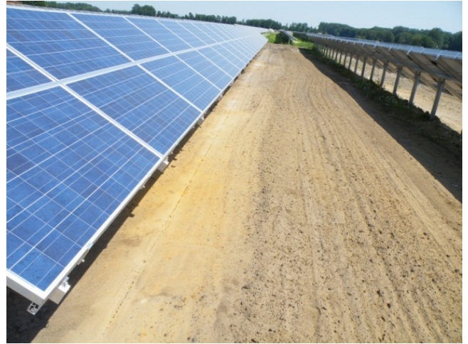
Abb.1: PV-Module nach der Installation auf einer Ackerfläche
