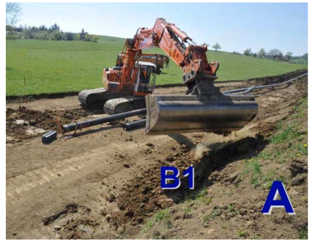
Abb. 1: Anlehen des "B1" an die "A"-Miete Bodenstruktur zu berücksichtigen, insbesondere wenn bis in 35 cm Tiefe keine Farbdifferenzen auszumachen sind, ist nach Unterschieden in der Struktur und Lagerungsdichte zu trennen. In Zweifelsfällen entscheidet ein Bodenkundler.
