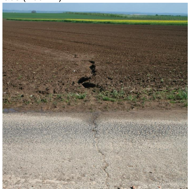
Abb. 11: Rillenerosion durch Fremdwasserzufluss vom Weg
