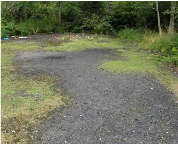
Abbildung 3: Mit Verbrennungsrückständen kontaminierte Fläche im UG.
